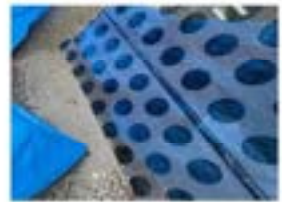
図2 雨水流入状況
